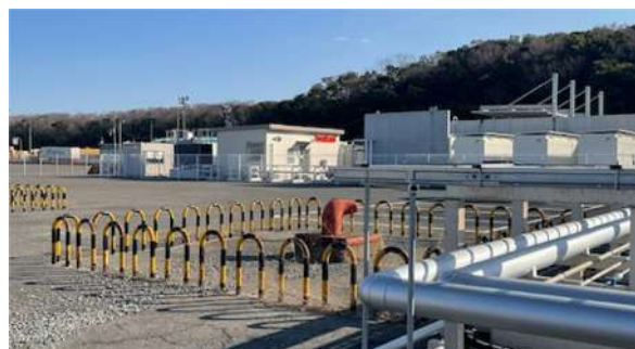
図10 エネルギー供給基地
