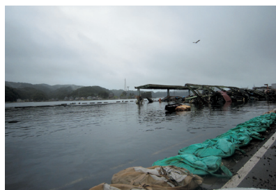
放置はゆるされない地盤沈下した岸壁
