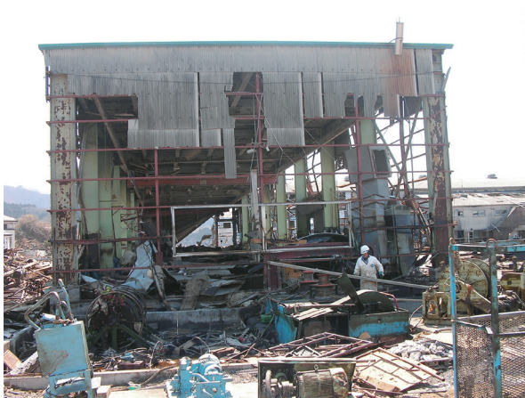
写真2. 東北関東大震災の被害写真 (大船渡管内) <H23.04.05撮影>
